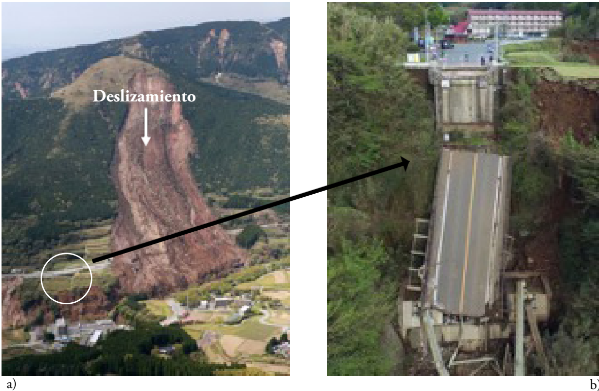
Figura 3. a) Deslizamiento de tierra sobre el puente Aso Ohashi, en Japón. el círculo indica el área del colapso; b) desplome del puente Aso Ohashi. Fuentes: a) elnuevodiario.com (17 de abril de 2016); b) El Diario de Coahuila (17 de abril de 2016).
