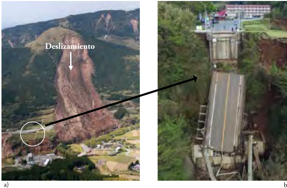
Figura 3. a) Deslizamiento de tierra sobre el puente Aso Ohashi, en Japón. el círculo indica el área del colapso; b) desplome del puente Aso Ohashi. Fuentes: a) elnuevodiario.com (17 de abril de 2016); b) El Diario de Coahuila (17 de abril de 2016).
