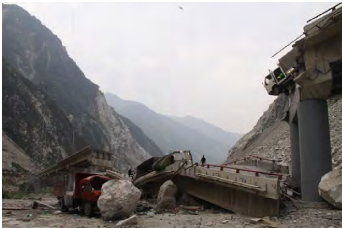
Figura 2. Destrucción parcial del puente Chediguan, en la provincia de Sichuan, China, por el cual circulaban 10 000 vehículos en promedio todos los días. Fuente: Xinhua, en china.org.cn (25 de julio de 2009).
